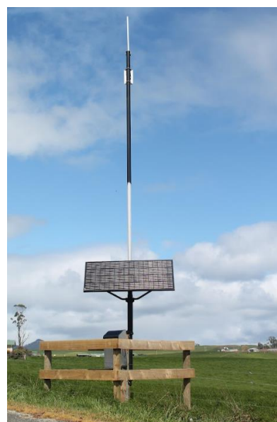
通信タワー。太陽光発電パネルを備え、電源設備は不要
